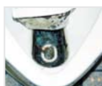
尿石が軟化して剥離している
